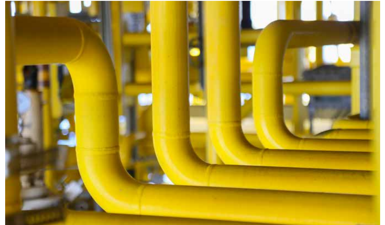
L'électrification du chauffage ne peut pas être un but en soi. Le gaz a encore un rôle à jouer dans le paysage du chauffage.
