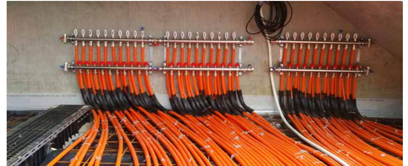
Les collecteurs sont logés sous l'escalier. (Photo: Radson)
