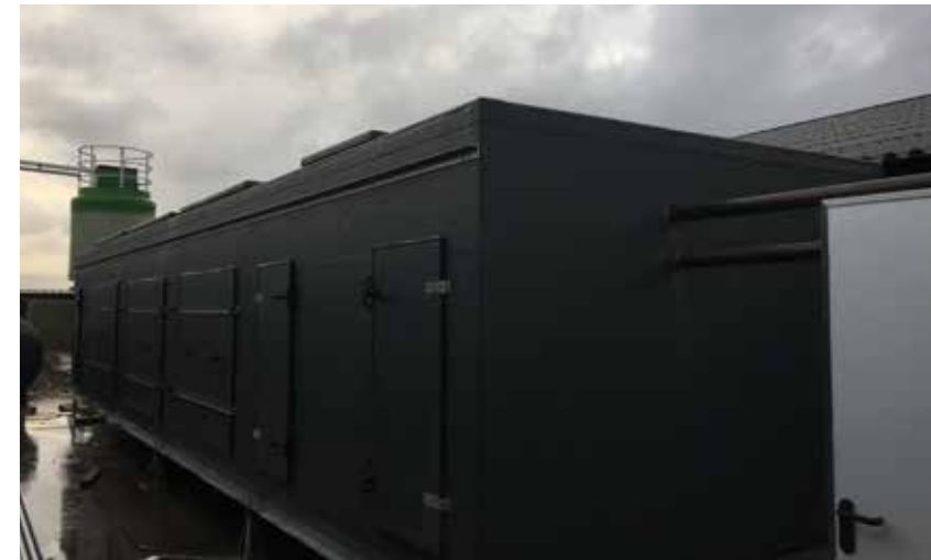
La chaudière dessert deux armoires de traitement de l'air, qui maintiennent à température les hangars abritant les poussins.
