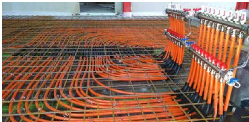
L'ensemble a été réalisé avec des conduites PexPenta de Radson. (Photo: Radson)
