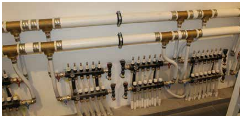
Lors de la conception de l'installation de chauffage par le sol, Intellisol a attaché beaucoup d'importance à l'optimisation hydraulique : on a posé des conduites de distribution de grands diamètres afin d'économiser de l'énergie de pompage.
