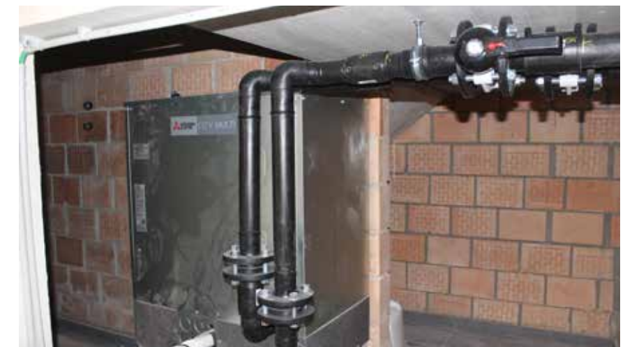
Le City Multi HVRF dans le bureau d'Intellisol est relié à un champ de sondes géothermiques.
