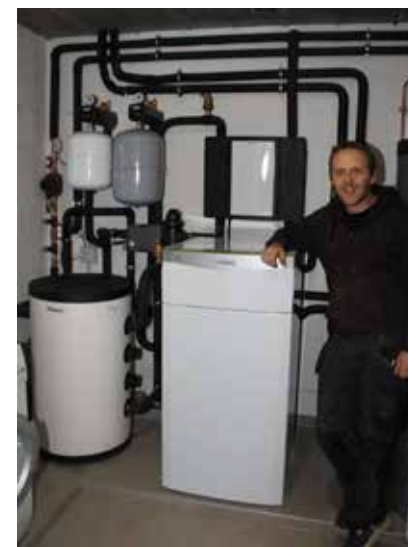
L'installateur Harry Dewulf de Bredene a décidé de montrer l'exemple en équipant sa maison d'une PAC Vaillant. (Photo: L'Entreprise)
