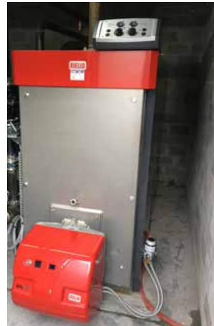
L'exploitation avicole est équipée d'une chaudière RTS 511 de 511 kW munie d'un brûleur RL50 au mazout.
