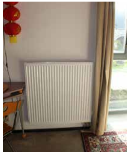
Dans les étages ont été placés des radiateurs surdimensionnés qui fonctionnent au même régime que le chauffage par le sol.
