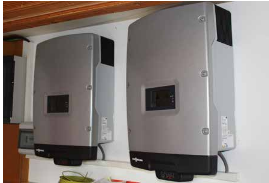
L'électricité nécessaire à la PAC est fournie par l'installation photovoltaïque.
