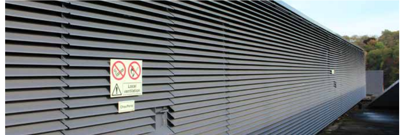
La chaufferie très design de la maison de repos Notre Foyer a été installée en toiture.
