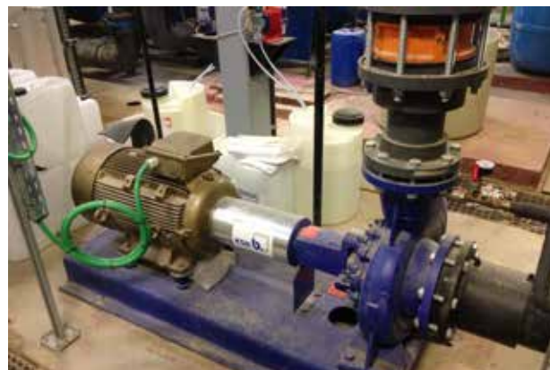
Les deux pompes KSB installées à Nivelles sont issues de la gamme Etanorm, une valeur sûre depuis les années 60.
