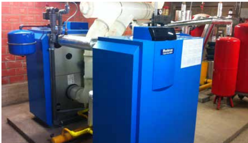
Pour la rénovation de l'immeuble de logements sociaux à Marcinelles, on a installé une cascade de deux chaudières sol gaz à condensation en fonte d'aluminium Buderus de type Logano plus GB 312, avec les kits cascade fumées et hydrauliques préfabriqués de Buderus. (Photo : Buderus)
