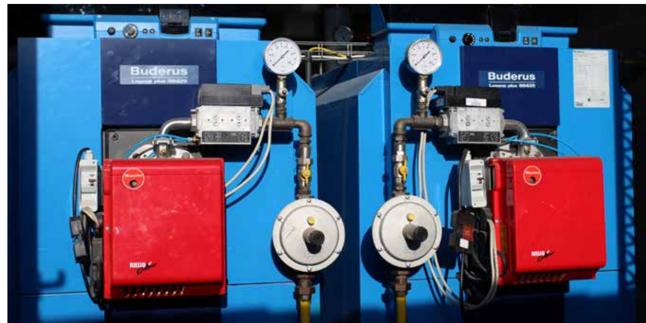
Deux chaudières sol gaz à condensation en acier inoxydable Buderus de type Logano plus SB 625 de 145 kW chacune et régulées en cascade par le système de régulation Logamatic 4000, servent au chauffage et à l'appoint d'ECS de la nouvelle aile de la maison de repos Notre Foyer de Marcinelle.
