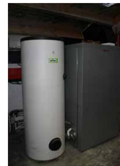
Une pompe à chaleur Vitocal 350A de 15 kW couvre la charge de base.
