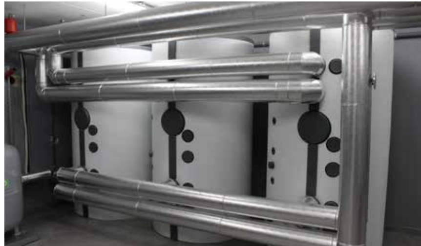
Les pompes à chaleur sont reliées à une installation de trois ballons tampon de 1.500 litres chacun.
