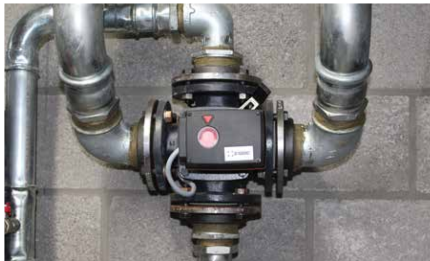
La vanne inverseuse, qui permet de passer en mode chaud ou froid.
