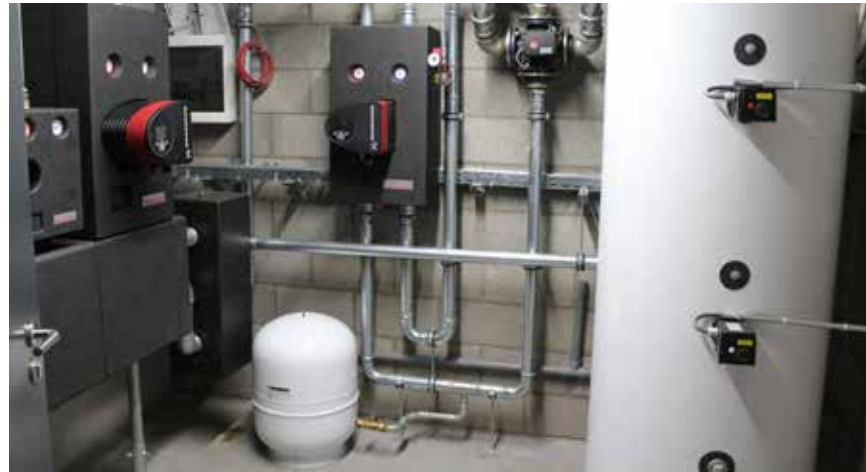
La chaufferie, avec les groupes de pompe, la vanne inverseuse, la régulation et le ballon de 500 litres. Ce stock tampon de 500 l permet à la PAC de ne pas devoir tourner en permanence ; on économise ainsi le compresseur de la PAC.
