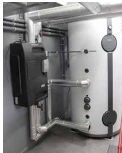
Pour l'ECS, on a prévu un chauffe-eau de 1.000 litres avec une station de charge.
