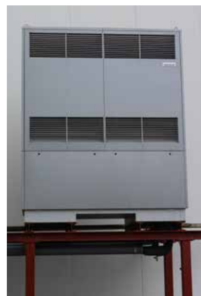
Dans le cas du concessionnaire Umberto de Loncin, le choix s'est donc porté sur une pompe à chaleur air-eau réversible pour installation extérieure WWP L 60 ADR de 60 kW de Weishaupt.
