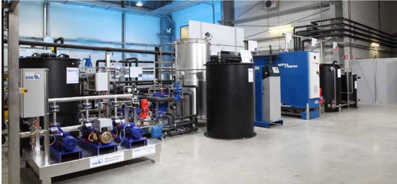
Pleinement opérationnelle, l'usine-école Learning Factory permet de tester les différents outils de réduction de la consommation d'énergie, dont les pompes et vannes
