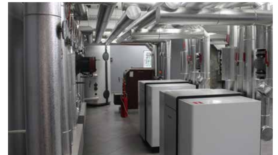
La chaufferie a également été entièrement rénovée avec du matériel de Stiebel Eltron.
