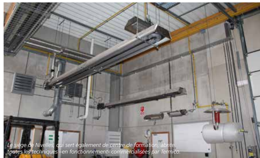
Le chauffage des couloirs de l'entrée principale « Princess Astrid » du Parc des Expositions de Bruxelles est assuré à l'aide de tubes radiants ECOGAS de Termico. (Photo : Termico)
