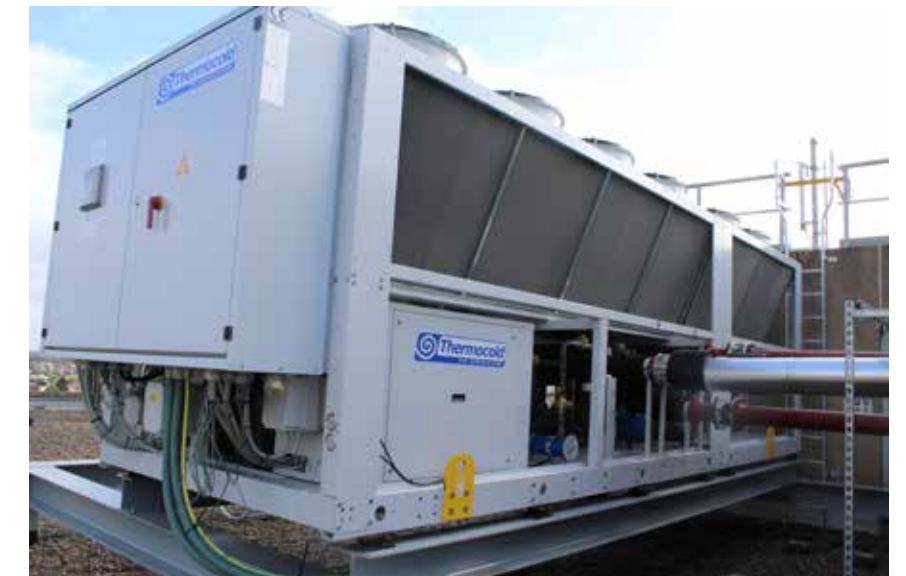
De basislast wordt gedekt door een warmtepomp.
