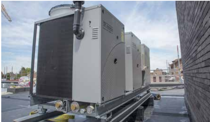
De cascade-opstelling van drie toestellen kan soepel inspelen op wisselende belasting.
