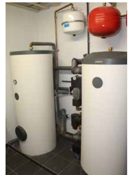
De warmtepomp is aangesloten op een buffervat van 200 l (rechts). Links ziet u de boiler voor SWW.
