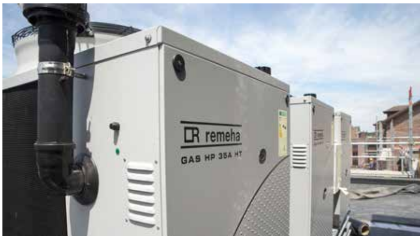
De regeling zorgt ervoor dat de warmtepompen het grootste deel van de warmtelast voor hun rekening nemen.
