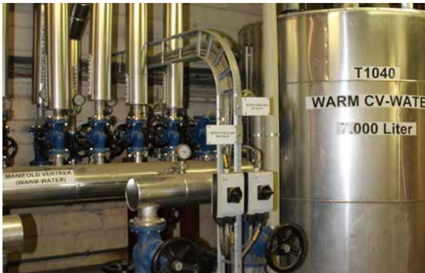
De verwarmingsinstallatie bij EOC wordt gevoed door een WKK-installatie via een buffervat.
