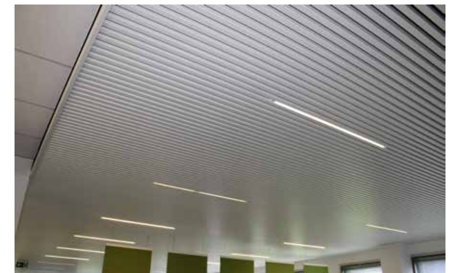
De kantoren van het Partena-gebouw werden uitgerust met klimaatplafonds.
