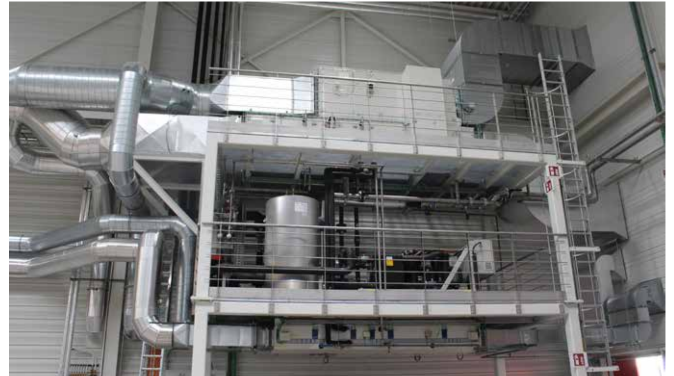
De HVAC-installatie werd op een draagstructuur in de productiehal geplaatst. Helemaal boven staat de grote luchtbehandelingskast voor de kantoren, in het midden bevindt zich de chiller en onderaan hangt de compacte luchtbehandelingskast voor het onthaalgedeelte.
