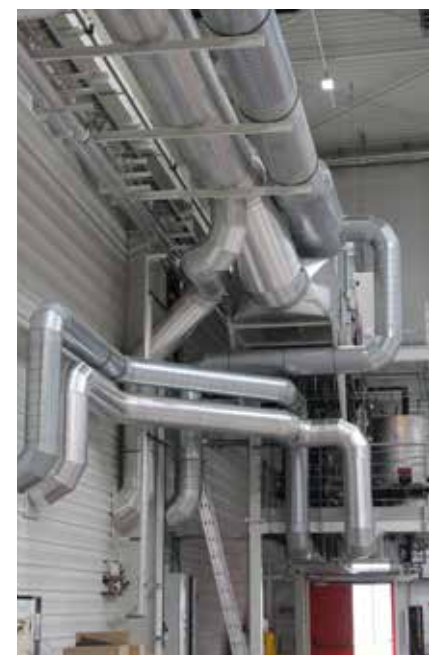
De luchtkanaalaansluitingen naar het onthaalgedeelte (onderaan) en de kantoren (bovenaan)
