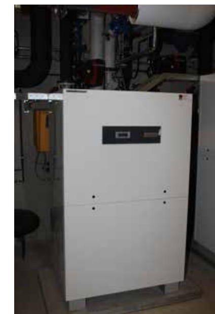
Le circuit à haute température est alimenté par une PAC S50-ID de 50 kW.
