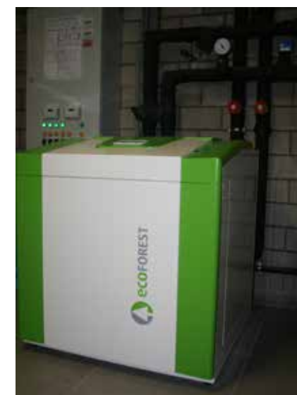
"Étant donné la surface (de bureaux) considérable, la PAC géothermique modulante Ecoforest fournit un COP de 7", ajoute Johan Cloet
