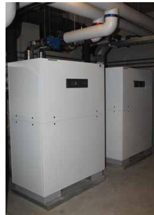
Pour le circuit basse température, on a prévu un dispositif en cascade avec deux PAC S90 ID de 90 kW chacune.
