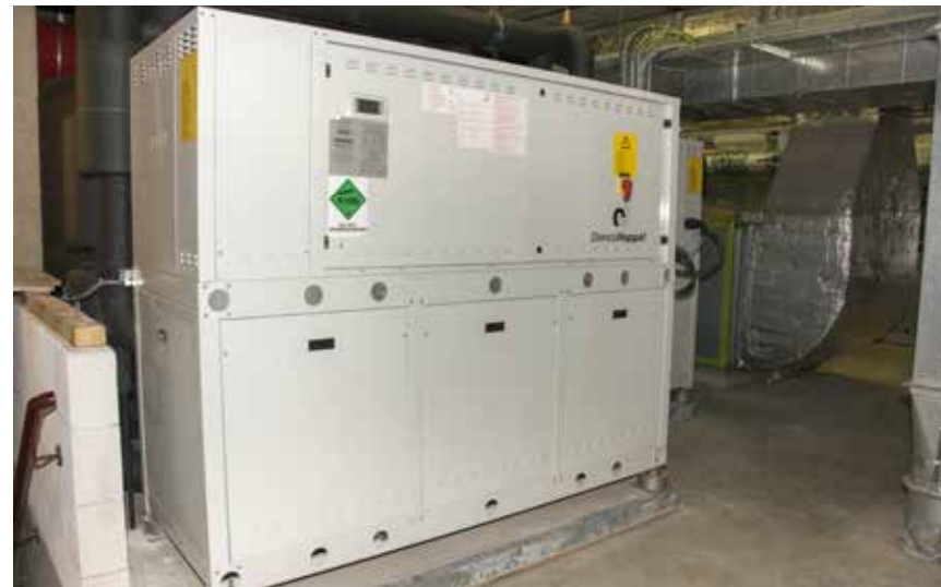
Le refroidissement est fourni par des groupes frigorifiques DencoHappel GLWC.
