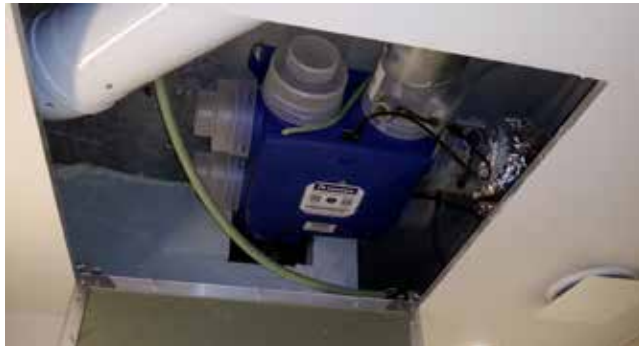
La Healthbox de Renson a été installée dans la conciergerie et les appartements du béguinage.
