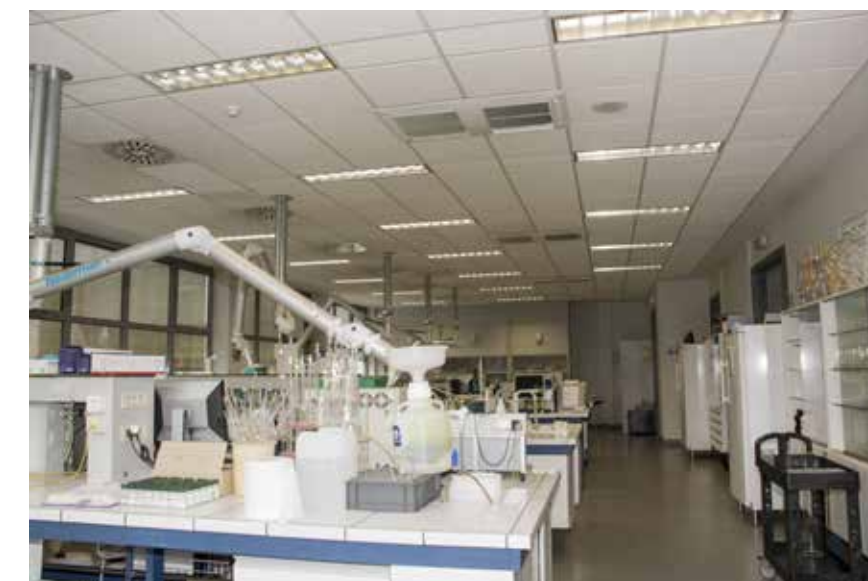
Dans les locaux à forte charge thermique interne, comme les laboratoires, des cassettes plafonnaires ont fourni de la puissance calorifique supplémentaire.
