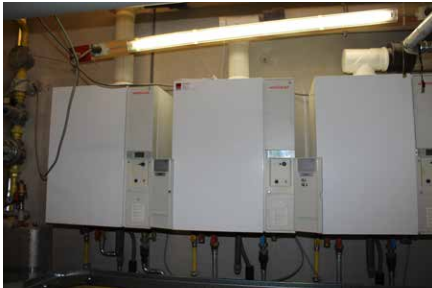
Les chaudières à condensation à haut rendement de Weishaupt servent d'appoint.
