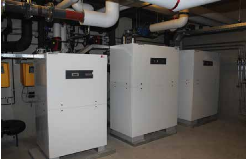
Le cœur de l'installation est constitué de trois pompes à chaleur sol-eau de Weishaupt.
