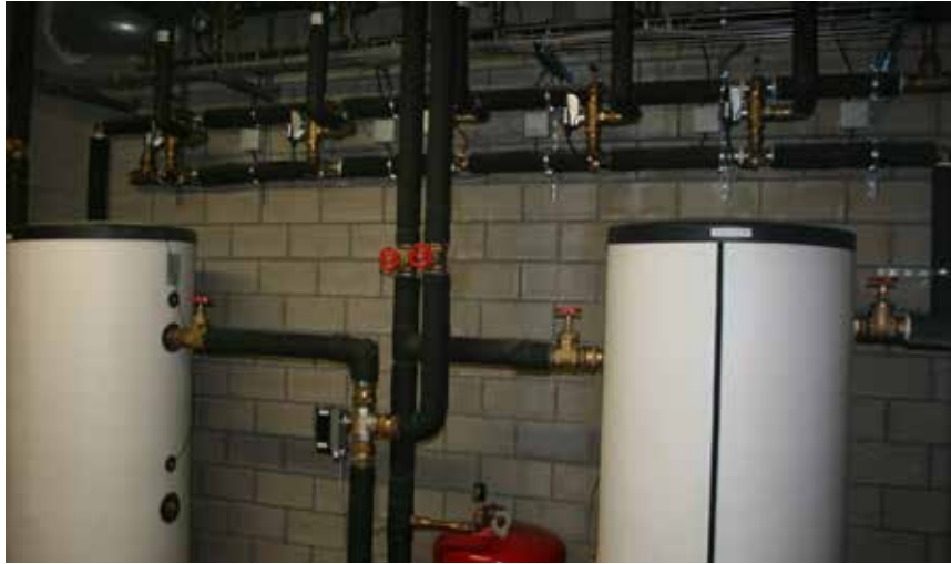
D'un point de vue de la technique de chauffage et de refroidissement, le bâtiment rénové est réparti en cinq zones.
