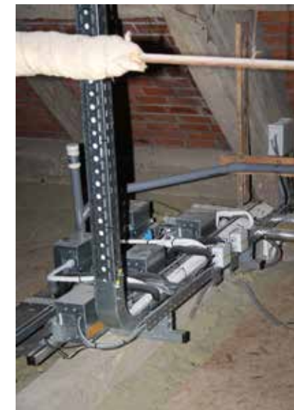
Afin de pouvoir raccorder les unités intérieures résidentielles au circuit VRV, les vannes d'expansion furent placées à part, dans le grenier par exemple.
