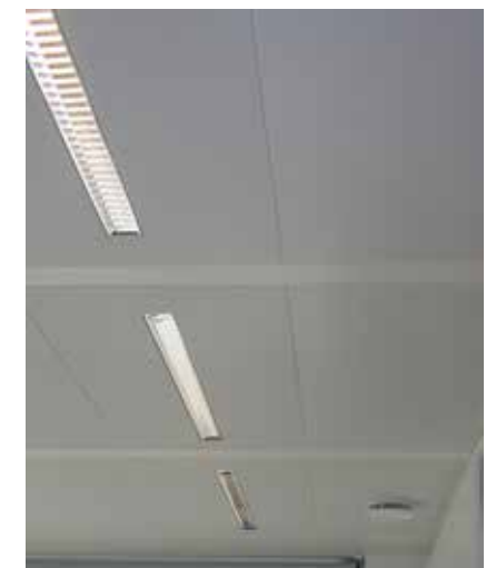
Tout comme dans le nouveau bâtiment, les espaces de bureaux dans le bâtiment rénové sont également refroidis et chauffés à l'aide de plafonds climatiques.
