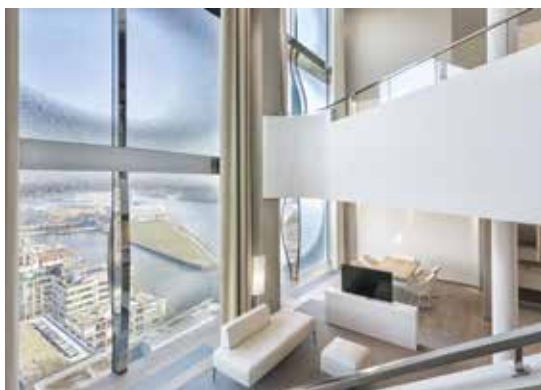
Pour ne pas obstruer la vue, on a utilisé dans l'hôtel The Westin Hamburg, des caniveaux installés au niveau des baies vitrées. Des ventilo-convecteurs Venkon Fan Coils garantissent quant à eux une ambiance agréable.
