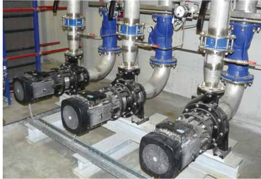
Des pompes monoblocs de la série NB distribuent de l'eau de refroidissement dans un bâtiment commercial.
