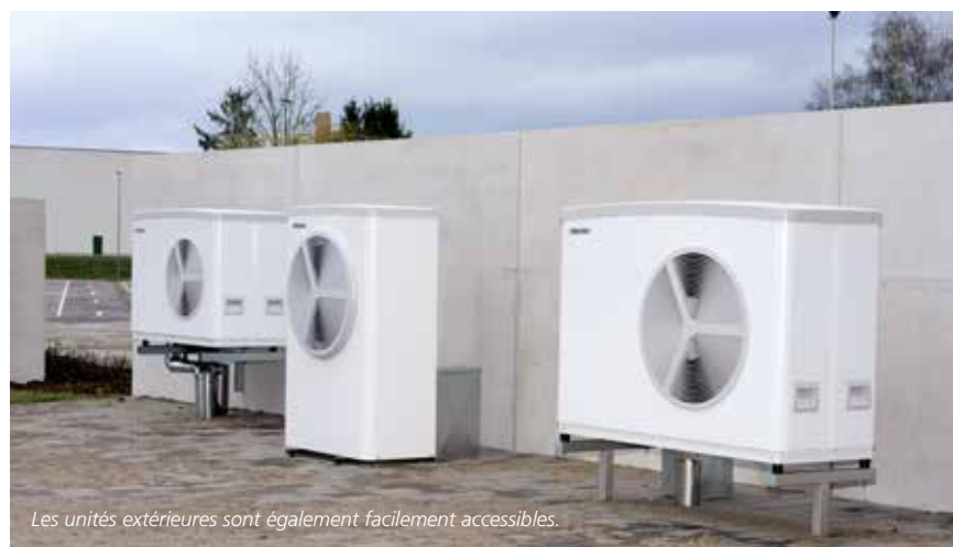
L'Energy Campus est chauffé à l'aide d'un dispositif en cascade de deux PAC eau-eau. La chaufferie fait partie du concept d'apprentissage.
