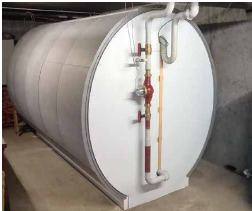
Figure 3B: le ballon tampon UniSto avec de l'isolant en coques Neopor.
