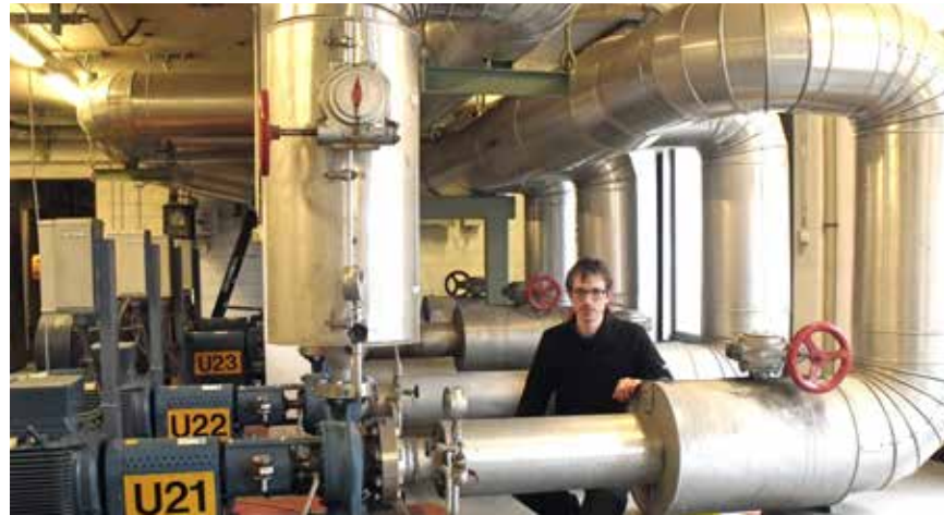
Jelle Rabaut auprès de quatre pompes destinées au réseau de chaleur.
